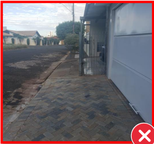
Portão invadindo passeio público
